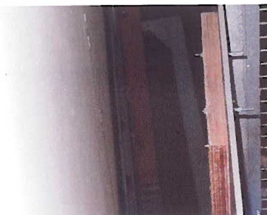
Figura 5: Reforço com uma placa de contraplacado de madeira.
